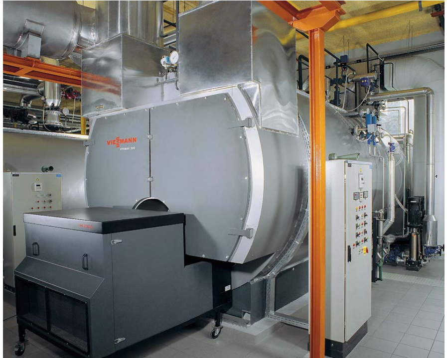
Bild 14: Dampferzeuger mit zwei Abhitzezügen in einem Krankenhaus
