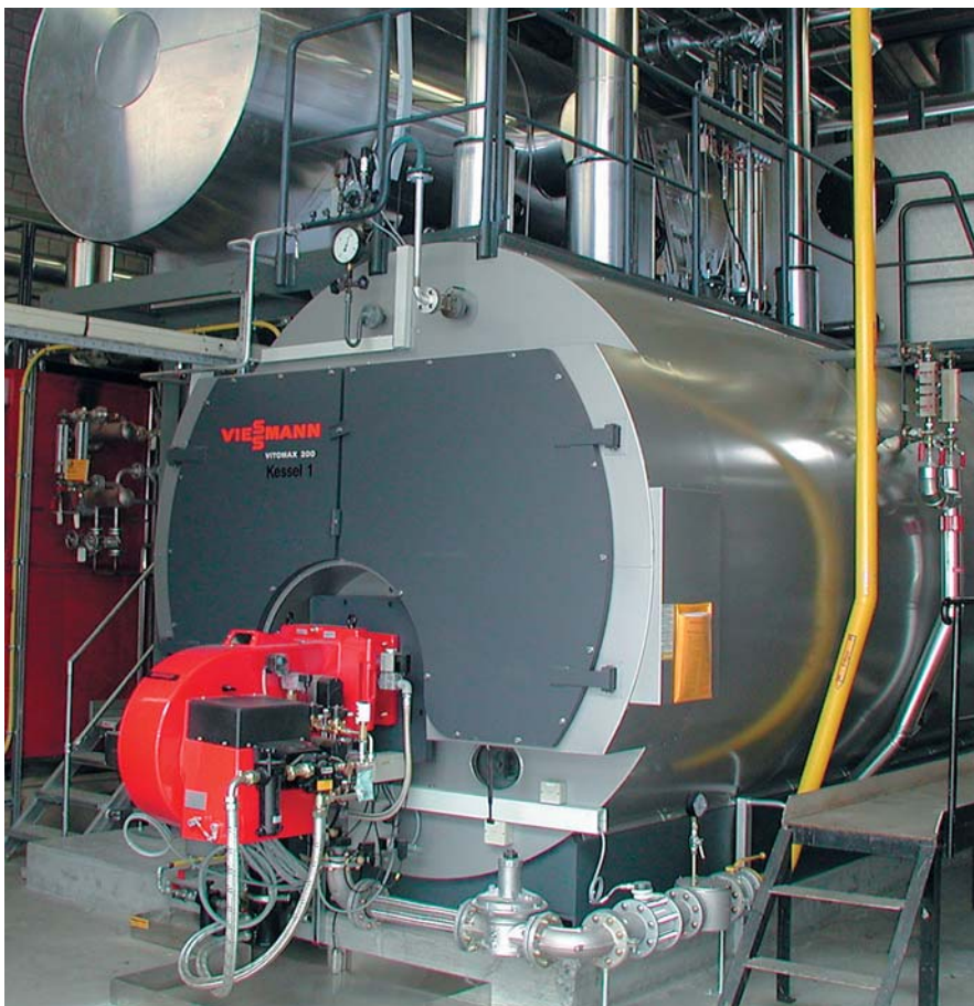
Bild 2: Dampferzeuger mit einer Dampfleistung von 4 t/h, 13 bar, mit integriertem Abhitzezug für ein BHKW mit 0,4 t/h (Abhitzeleitung noch nicht angeschlossen)
