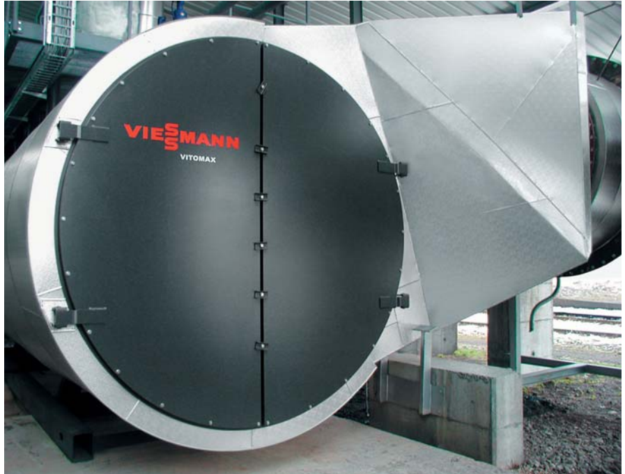
Bild 6: 1-Zug-Abhitzeessel zur Heißwassererzeugung
