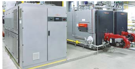
Blockheizkraftwerk Vitobloc 200 und Niedertemperatur-Heizkessel Vitoplex 300
