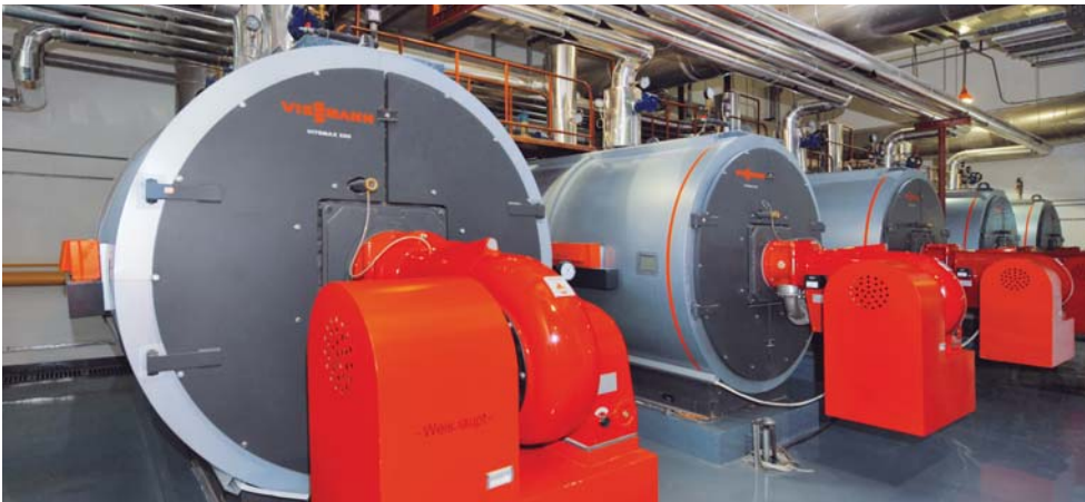
Vitomax Dampf- und Heißwassererzeuger in der Heizzentrale des Hotels
