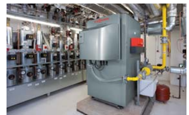
Ein Gas-Brennwertkessel Vitocrossal 200 schaltet sich bei Bedarf zu.
