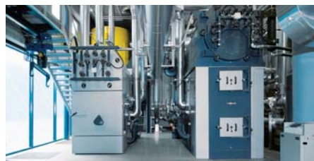
Zwei Vitoflex Kessel 300-FSB und 300-FSR mit einer Gesamtleistung von 1650 kW
