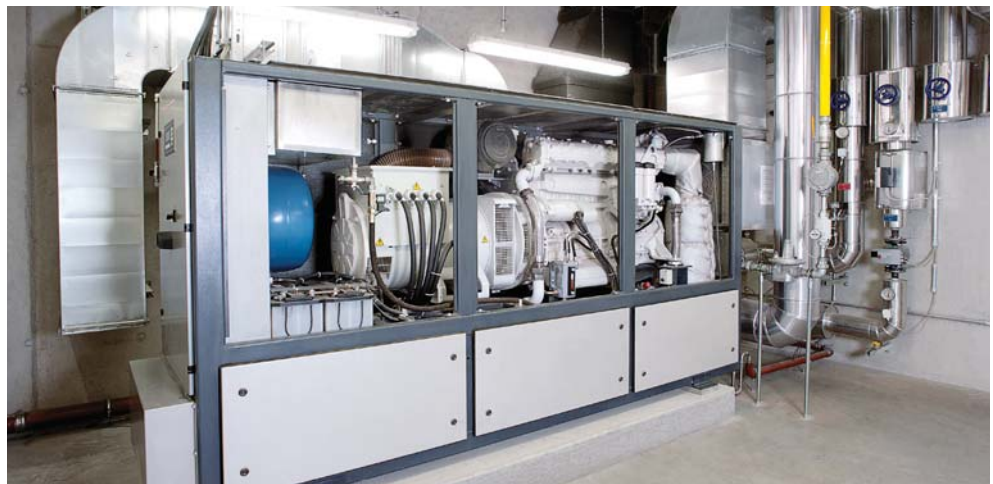
Blockheizkraftwerk Vitobloc 200, Nahwärmenetz Memmingen, Deutschland
