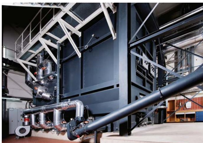
Einer der beiden Biomassekessel Vitoflex 300-FSR mit einer Gesamtleistung von 10 MW
