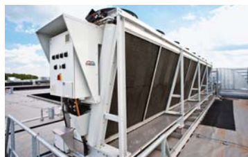
Rückkühler für die Wärmepumpe auf dem Dach des Gebäudes
