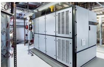
Blockheizkraftwerk Vitobloc 200 mit Leistungen von 238 kW el und 363 kW th
