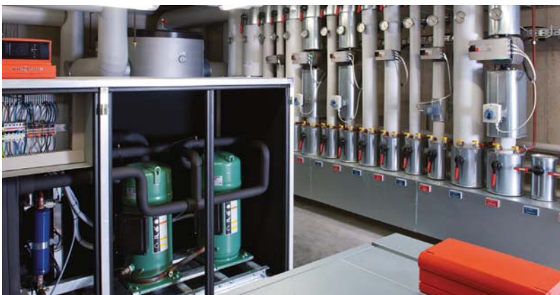
Herzstück der Wärmepumpen sind die sogenannten Scroll-Verdichter
