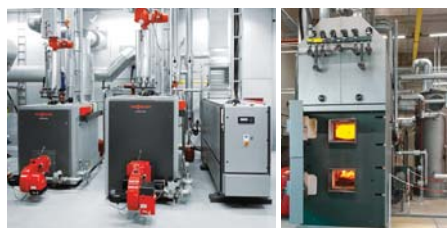
Zwei Gas-Niedertemperatur-Heizkessel Vitoplex 200, BHKW Vitobloc 200 und Hackschnitzelkessel Vitoflex 300-FSB mit einer Leistung von 900 kW (v.l.)
